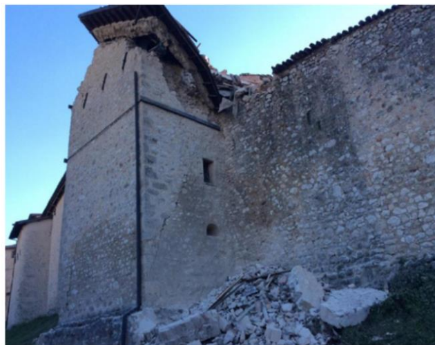
2. ábra: Nem megfelelő beavatkozás eredménye a kő falazaton [3]
