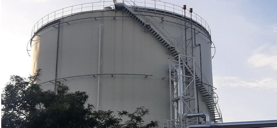
17. ábra: Csatlakozó felső vízvezeték a hőtárolónál
