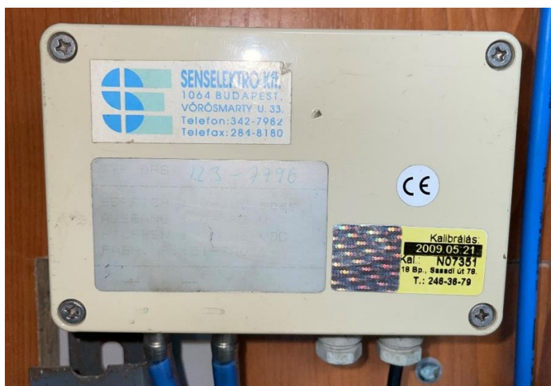
3. ábra: A meglévő nyomásmérő
