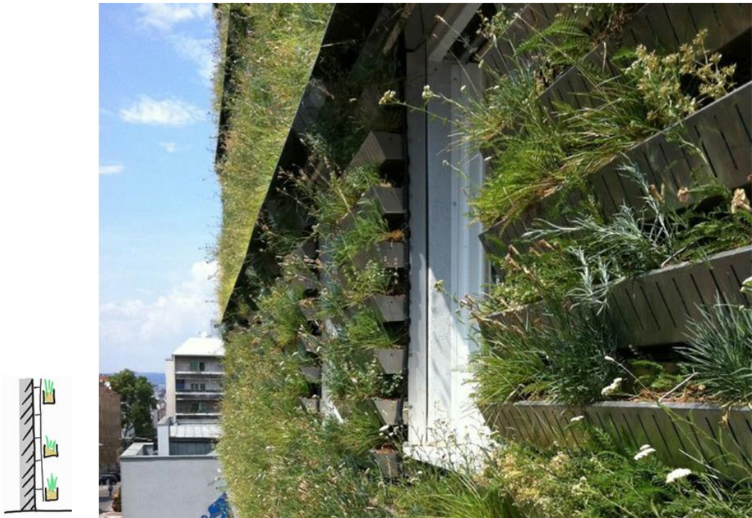
24.ábra: Ültetőedény-soros zöldhomlokzat
