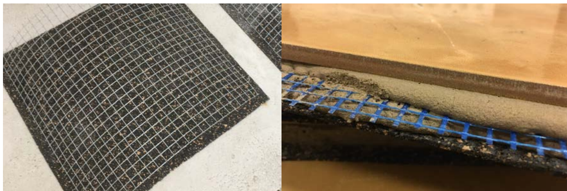
19. ábra: A két fotón jól látszik a hálóerősítés felgöbülése, a háló magassági pozíciójának bizonytalansága
