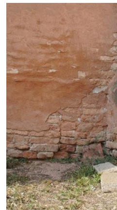
106. kép Somogyszil. Falelválás a nyugati torony északi falában
