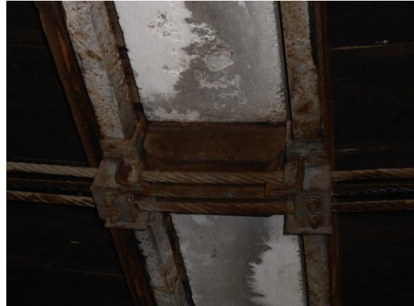
35. kép: a köteleken megjelent a korrózió 2015.07.03.
