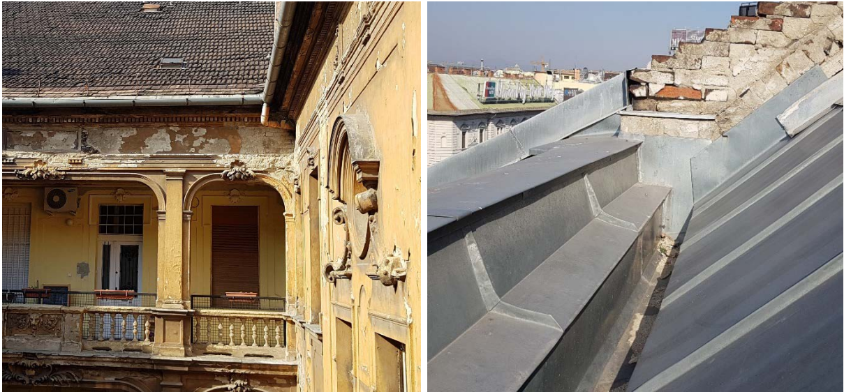
A belső udvar és az utcafront vízvezetése. Fotók: Kozák Ágnes
