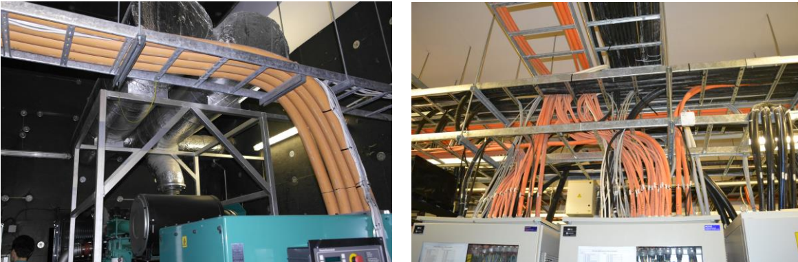
6.7. ábra: Nagy átmérőjű elektromos kábelek elhelyezése a kábeltálcákon (bal oldali képen a diesel aggregát, jobb oldali képen az elektromos elosztó központ, képek készültek: 2013. 05. 24.)
