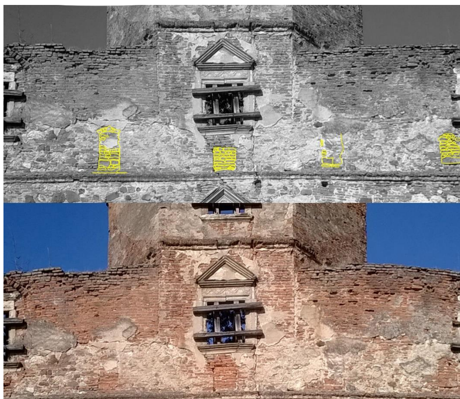
8. kép A főhomlokzaton láthatóvá vált egykori nyílászor. saját fotó
