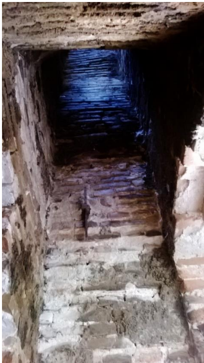
22. kép Kéménykürtő a "kapuköziben" az aranyosmeggyesi kastélyban. saját fotó
