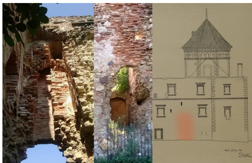
12. kép Kéménykürtő és kitört falszakasz az aranyosmeggyesi kastély homlokzatán. saját fotók, és BME Építészettörténeti és Műemléki Tanszék Rajz-és Fotótára [102416] részlet
