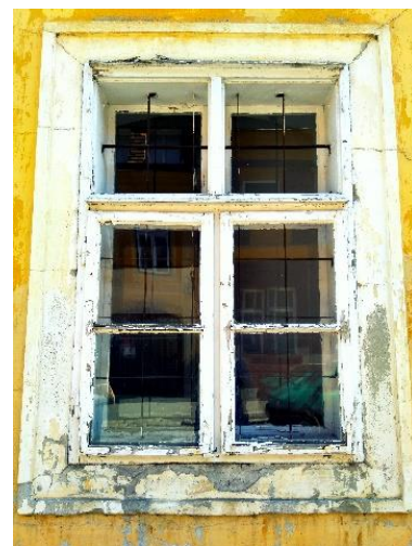
27. ábra: NYÍLÁSZÁRÓ KÁROSODÁSA
