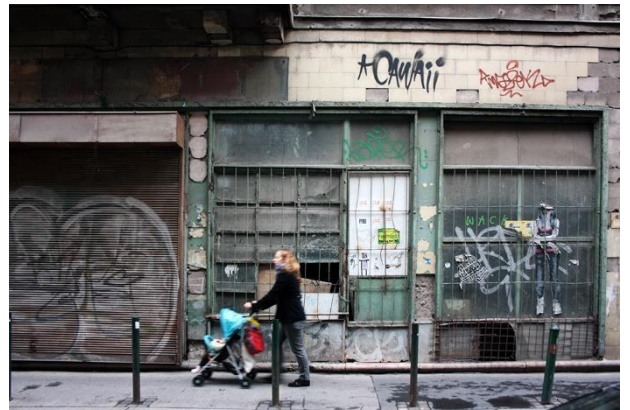
Székely Mihály utca 9. (Melléklet, 45.sor) graffitikkal csúfított homlokzat
