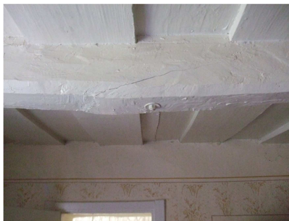
16. ábra: A fa gerenda tönkremenetele a behajlás következtében, illetve annak megerősítése (saját fotó)
