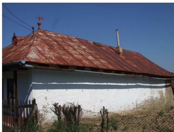
10. ábra: Csapadékfelveredés okozta vakolatleválás (saját fotó)
