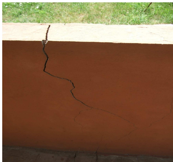
6. ábra: Függőlegesen lefelé haladó átmenő repedés a tornác parapetfalán (saját fotó)
