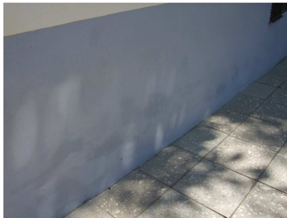
8. ábra: Nedvesedésből származó foltok az épület külső térelhatároló szerkezetén (saját fotó)
