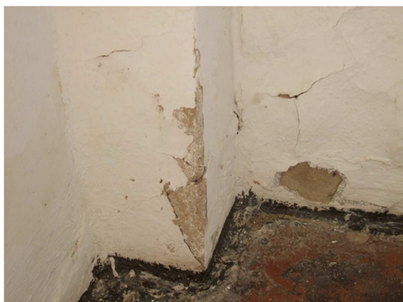
9. ábra: Nedvesedésből származó hólyagos vakolatleválás a tornác belső oldalán (saját fotó)
