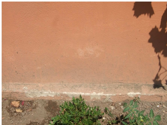
7. ábra: Nedvesedésből származó foltok az épület külső térelhatároló szerkezetén (saját fotó)
