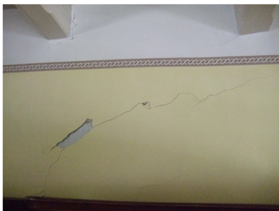
11. ábra: Repedések és vakolatleválás a külső teherhordó fal belső oldalán (saját fotó)
