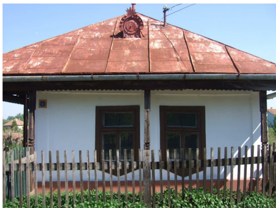
17. ábra: Az ablakok deformációja a homlokzaton (saját fotó)
