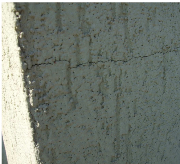
5. ábra: Az üvegezett tornác utcahomlokzati tartóoszlopán keletkezett vízszintes repedés az altalaj süllyedése következtében (saját fotó)
