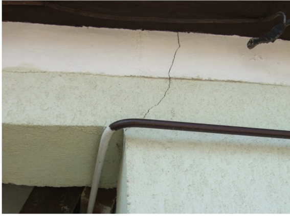
13. ábra: Függőleges repedés a tornác és a teherhordó fal csatlakozásánál (saját fotó)
