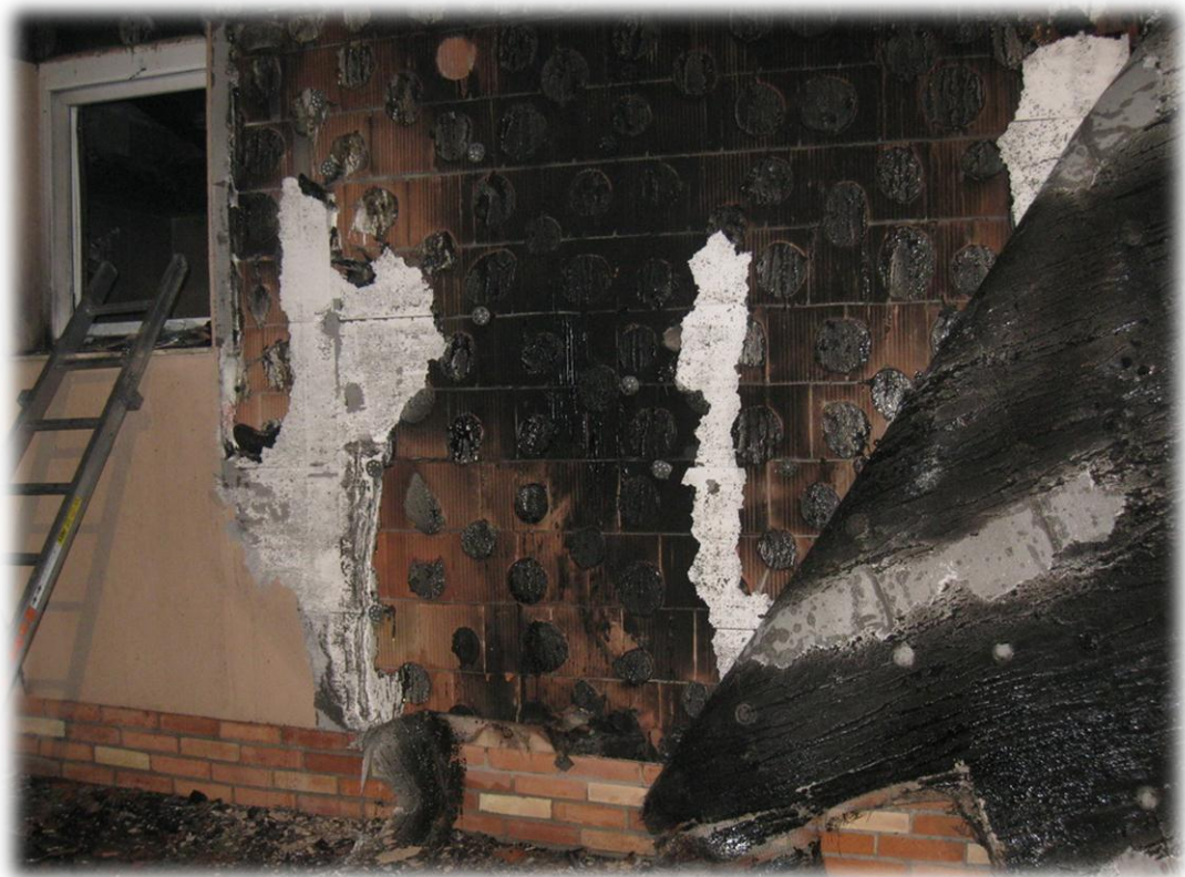
2.15. ábra: Polisztirolhab hőszigetelés tüzeset után [18]
