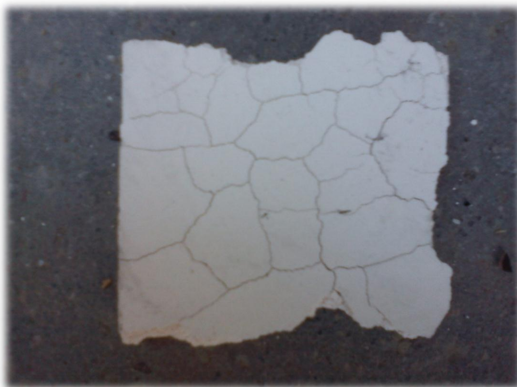
4.3. ábra A gipsz hálós repedései
