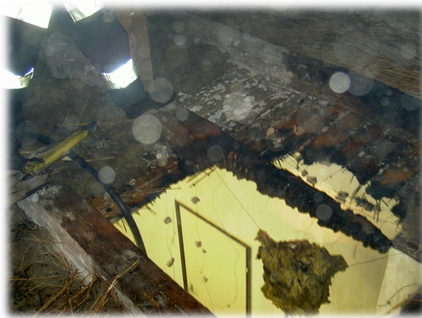
2.4. ábra: Tönkrement faszerkezet [2]
