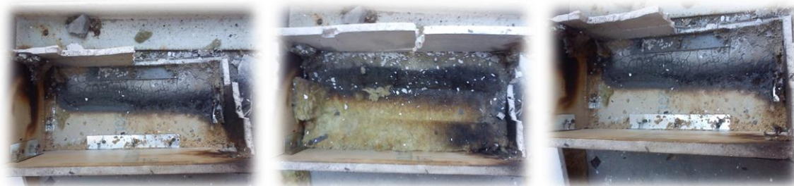
4.8. ábra: A sérült csavarozott kapcsolatok
