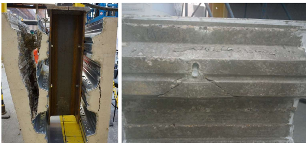
3.5. ábra: Próbatetek tönkremenetele beton nyírásával [7] [4]
