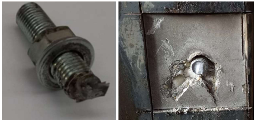
4.9. ábra: Kapcsolóelemek és a beton tönkremenetele [16]
