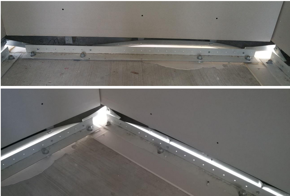
28. ábra T1 épület tönkremenetele
