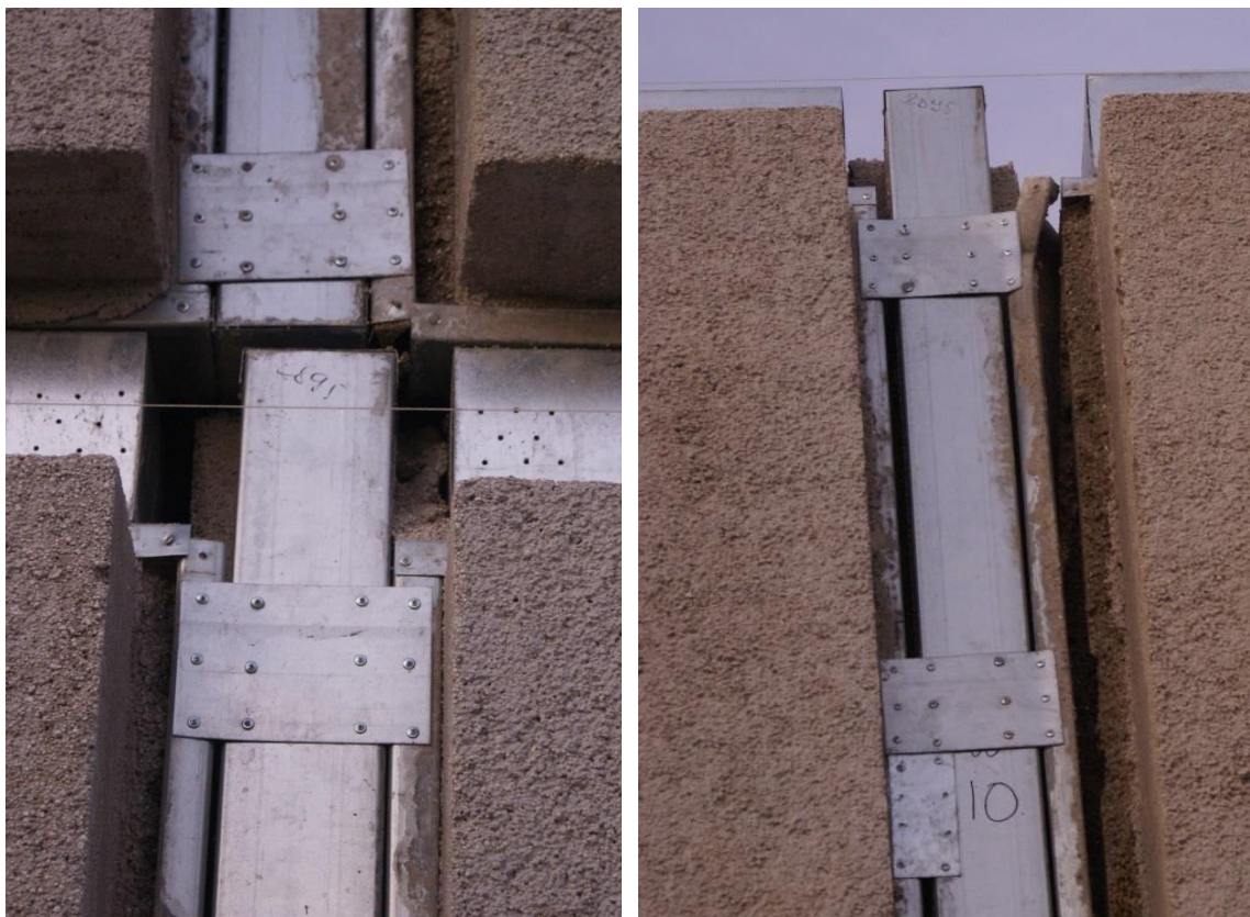
34. ábra T3 jelű épület tönkremenetele csomóponti erősítés nélkül (T3-h3-ult2)
