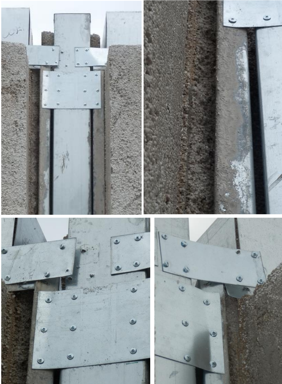
30. ábra T2 jelű épület tönkremenetele
