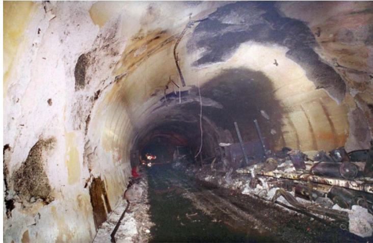
2.5. ábra: Mount-Blanc alagút a tüzeset után [ tunneltalk.com/Fire-safety/ ]
