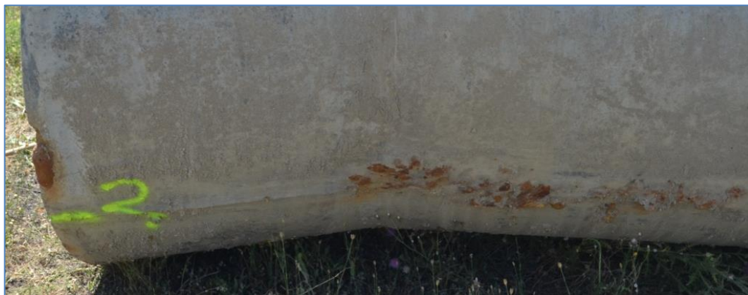
6.3. ábra: Zsaluillesztésnél észlelt rozsdafolt üzem kívüli csövön (Kép készült: 2013. 07. 17.)
