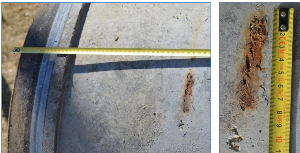
6.7. ábra: A csőszár végének közelében észlelt hosszanti rozsdafolt (Képek készültek: 2013. 07. 22.)
