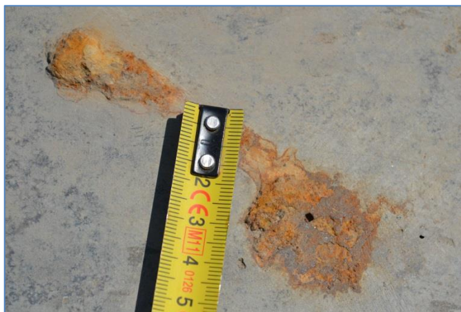
6.9. ábra: Beton felületén észlelt rozsdafolt a rozsdatermék eltávolítását követően, kép készült: 2013. 07. 17.)
