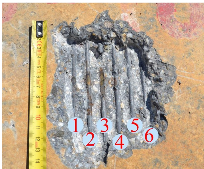
6.25. ábra: Hozzávetőlegesen 4 \times 5 cm kiterjedésű rozsdafolt feltárása (Kép készült: 2013. 07. 22.)
