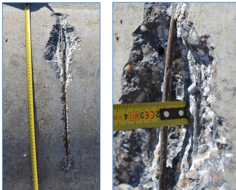
6.24. ábra: II. számú cső szár végénél tapasztalt hosszanti rozsdafolt feltárása (Képek készültek: 2013. 07. 22.)
