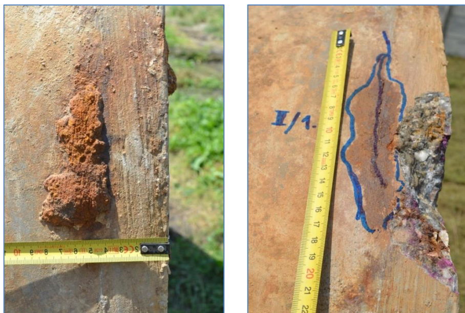
6.10. ábra: A tok végének közelében megfigyelt rozsdafolt a szemrevételezés elején és a rozsdatermék eltávolítását követően (Képek készülték: 2013. 07. 18.)
