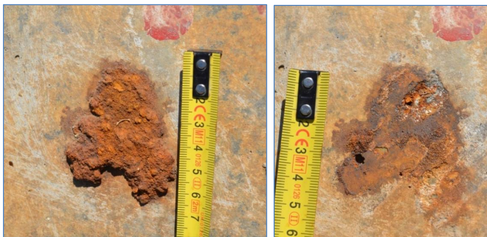
6.8. ábra: Beton felületén észlelt, hozzávetőlegesen 5×4 cm kiterjedésű rozsdafolt a felmérés kezdetén és a rozsdatermék eltávolítását követően, képek készültek: 2013. 07. 17.)
