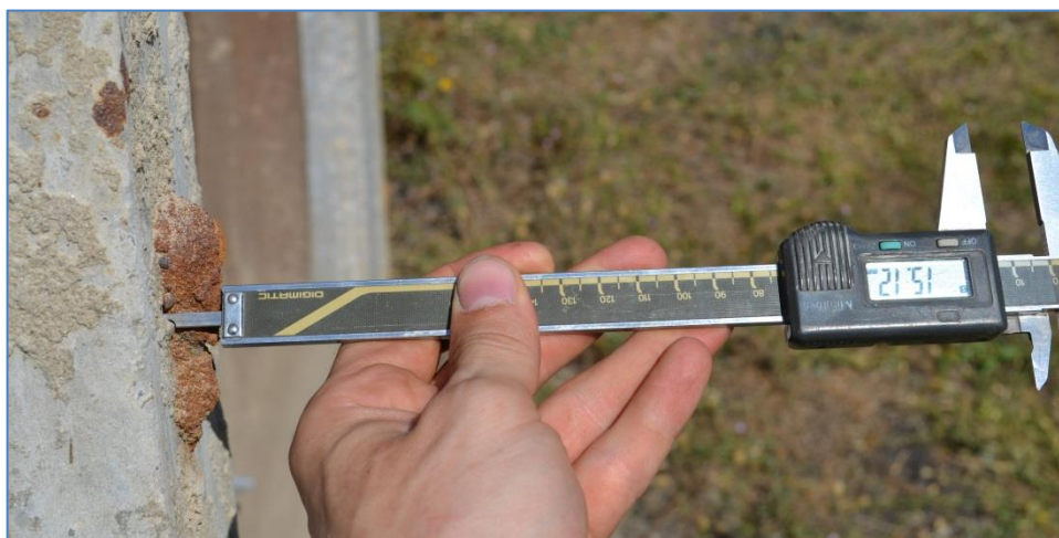
5.1. ábra: Cső bütös felületén észlelt rozsdafolt magassági méretének meghatározása tolmérő segítségével (Kép készült: 2013. 07. 17.)
