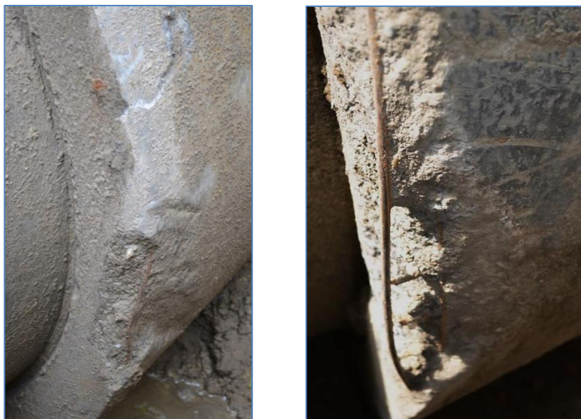
6.11. ábra: Munkagödör kiemeléskor megsértett betonfedés (A képek két különböző munkagödörben készültek 2013. 05. 06-án)
