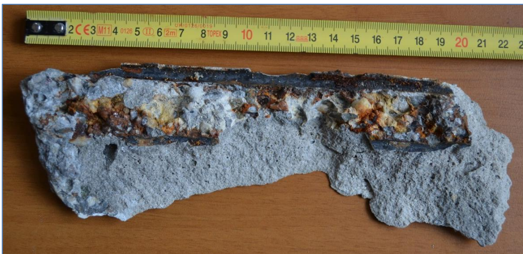
6.15. ábra: Tokvégről levált darab (Kép készült: 2013. 05. 06.)
