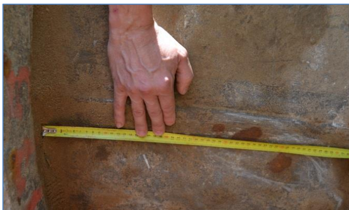
6.2. ábra: Zsaluillesztésnél észlelt rozsdafolt üzem alatti csövön (Kép készült: 2013. 04. 25.)
