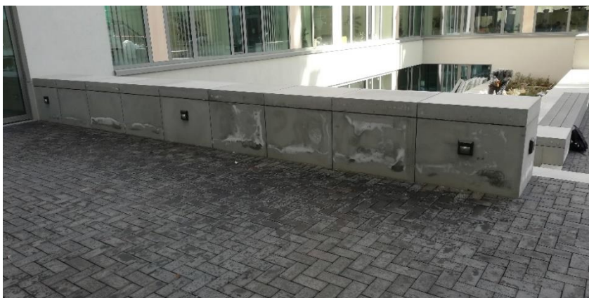
28. ábra: Kivirágzott beton felület
