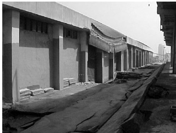
32. ábra: Egyenlőtlen süllyedések következtében tönkrement épületrész. Taichung kikötő, Tajvan (1999)
