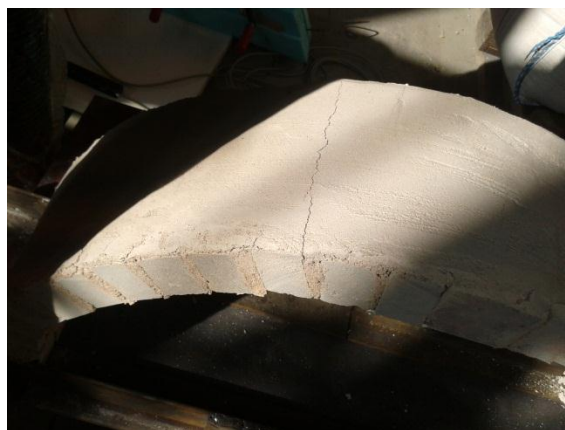
20. ábra. Az átmenő repedés a szerkezeten
