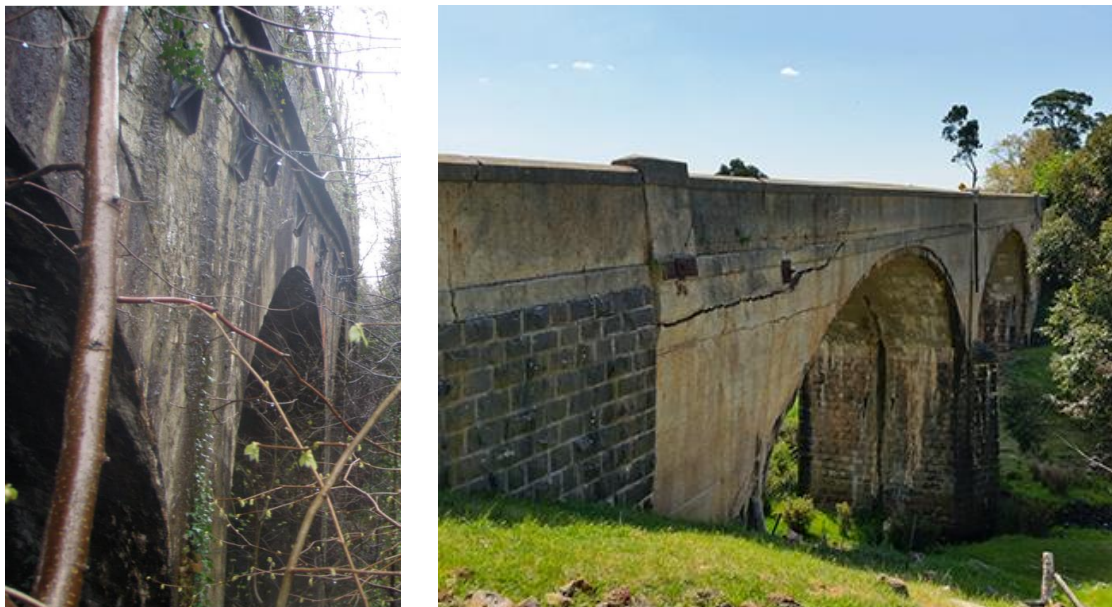
5. ábra – Homlokfal kihasasodásával járó károsodás [14]
