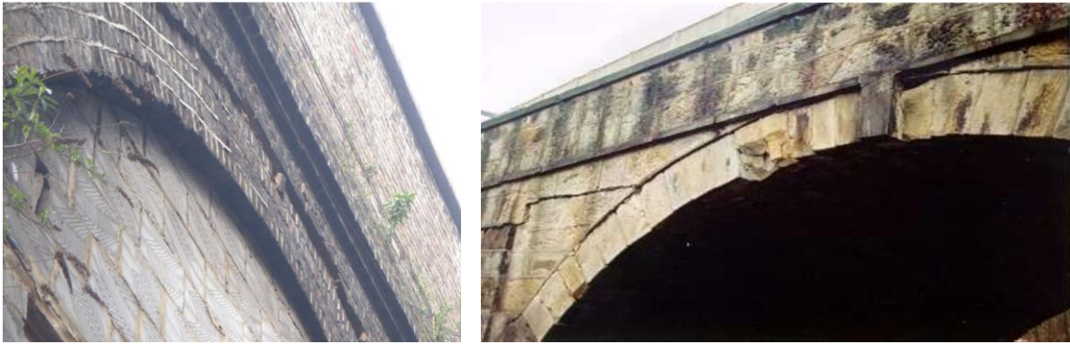
6. ábra – Homlokfal elcsúszásával járó károsodás [14, 15]
