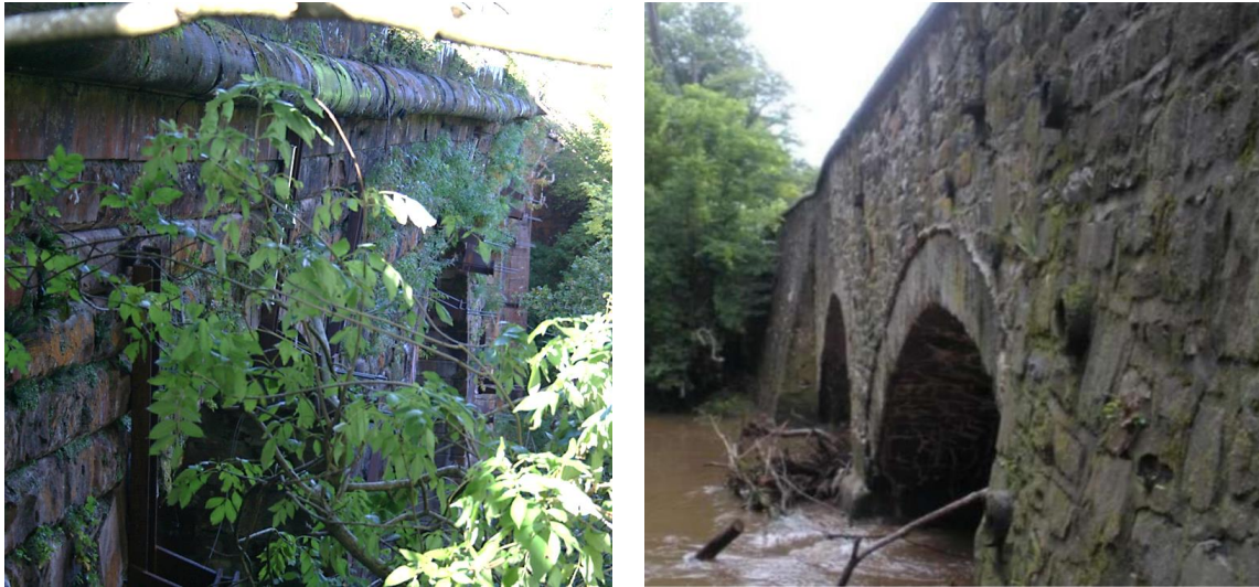
4. ábra – Homlokfal elfordulásával járó károsodás [14]
