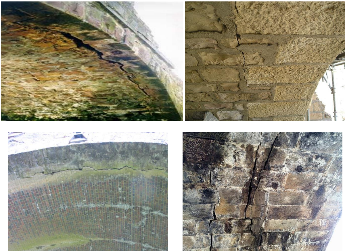
7. ábra – Homlokfal leválásával bekövetkező károsodások [14, 16]
