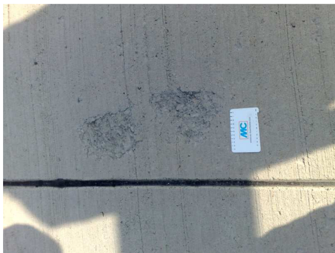
4. fénykép: A felületi nyomokban keletkezett felfagyás.
