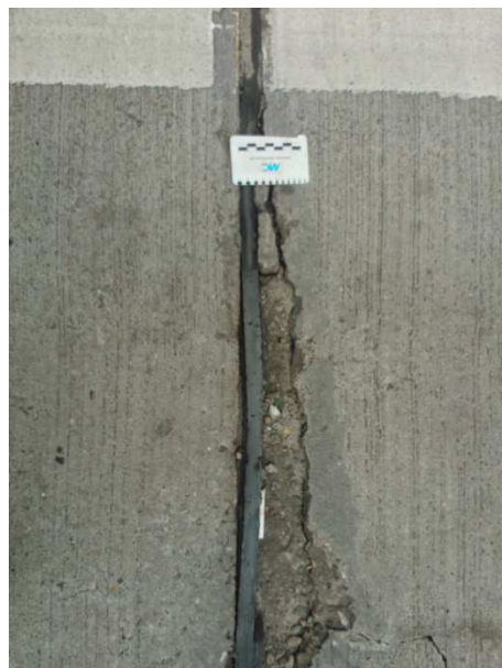
6. fénykép: A villamosvágány térbetonja dilatációjának él tönkremenetele
