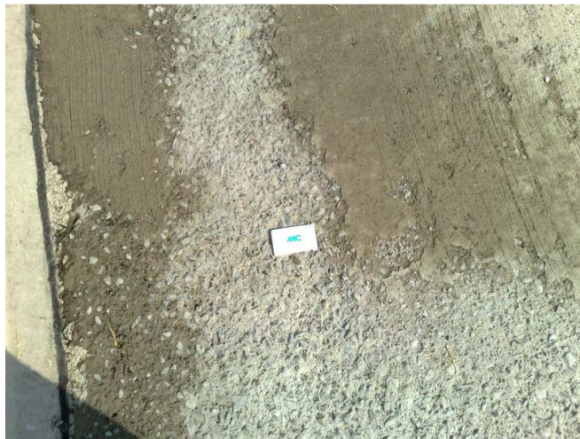
3. fénykép: Korai fagyás okozta felületi lehámlás a beton burkolatban
