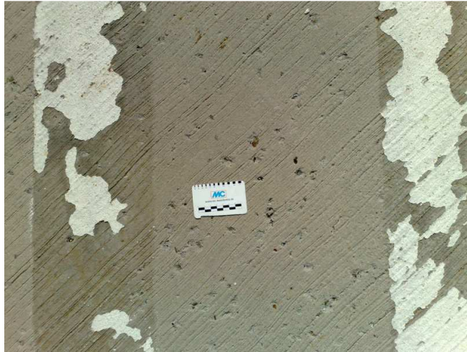
2. fénykép: Fagyás okozta pontszerű lehámlás a beton burkolatban.
