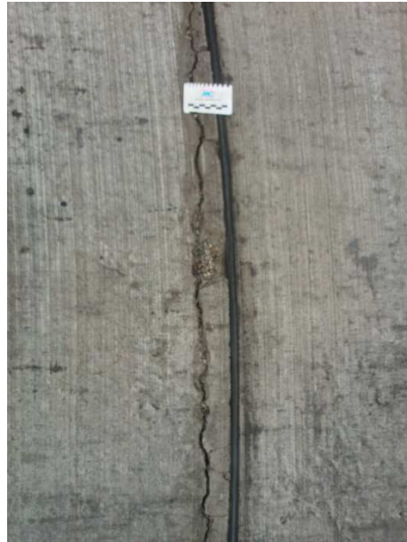
5. fénykép: A villamosvágány térbetonja dilatációjának él letörése
