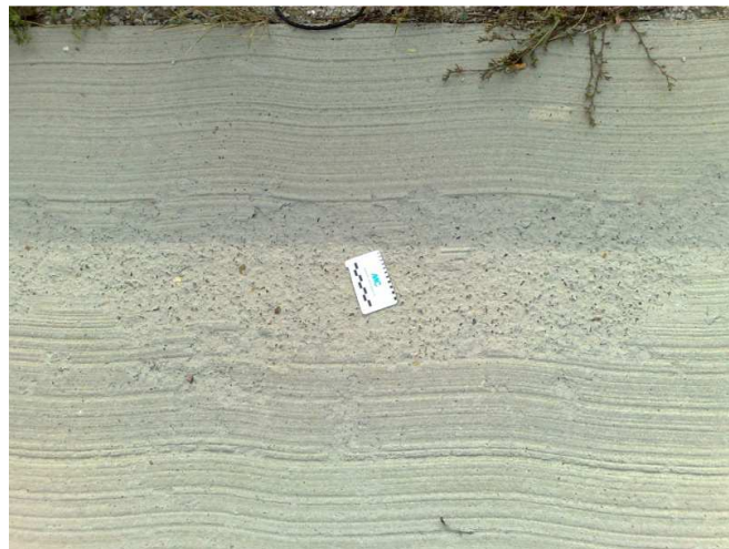
1. fénykép: Fagyás okozta felületi lehámlás a beton burkolatban.
