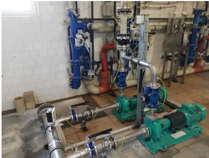
3.4-2. ábra Technológiai feladó szivattyúk
