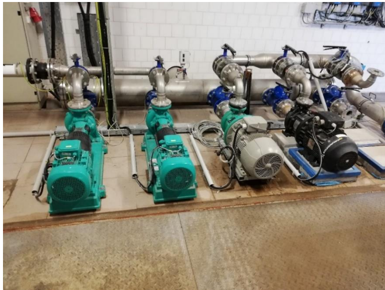
3.4-8. ábra Hálózati nyomásfokozó szivattyúk
