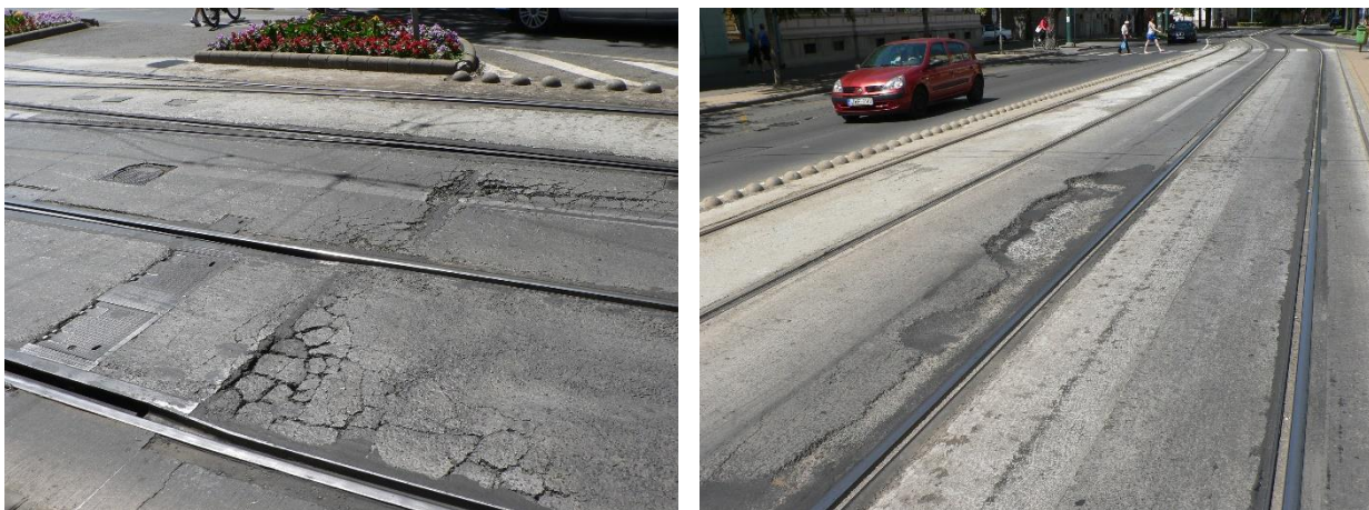
20. kép: Densiphalt burkolat állapota pár hónappal a beépítés után [3]
