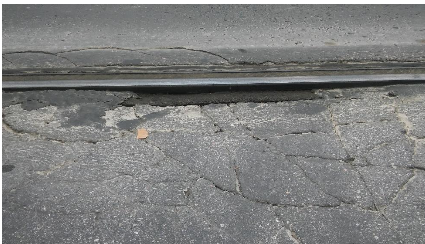
10. kép: kitöltő anyag teljesen hiányzik, hálós repedések indultak el az aszfaltban
