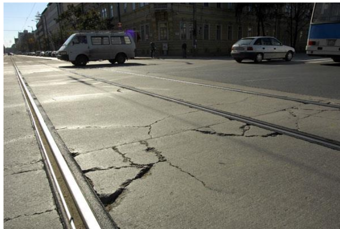
15. kép: burkolati hibák a Párizsi körút – Kossuth Lajos sugárút csomópontban [3]
