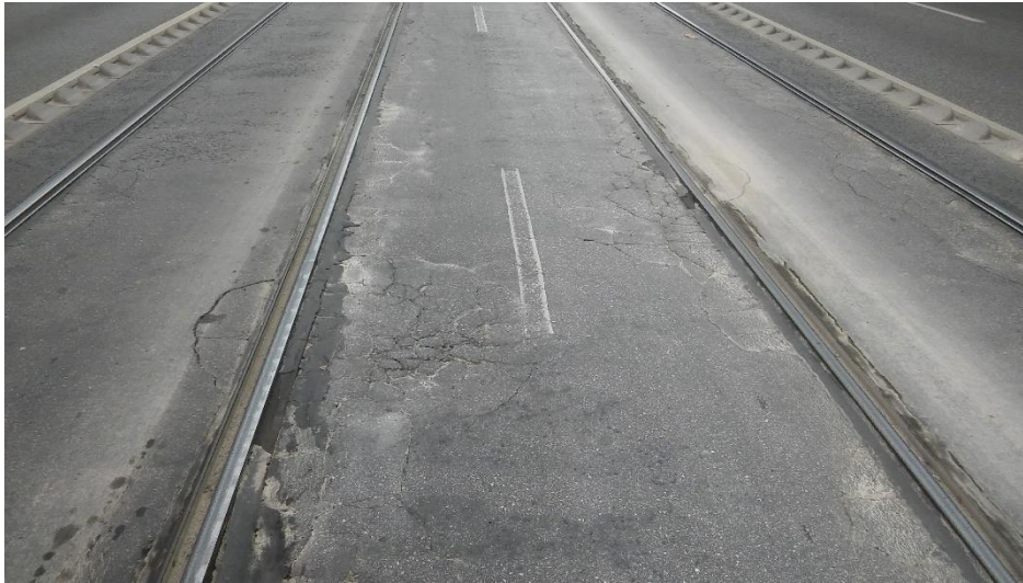
11. kép: a sínszál-burkolat kapcsolatból kiinduló burkolati hibák
