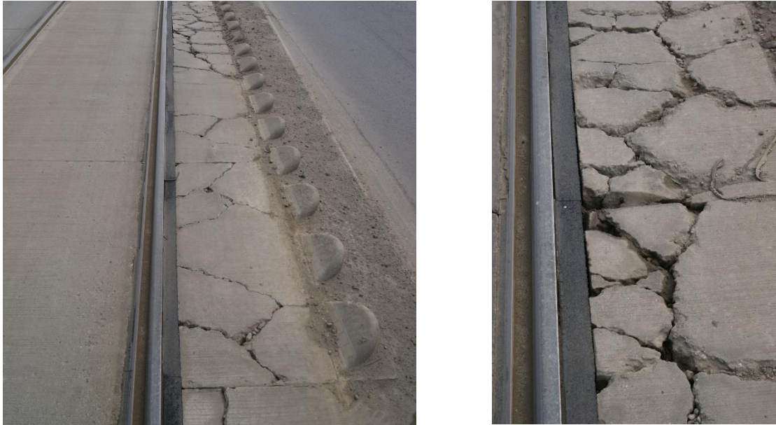
14. kép: hálós repedésekből kialakult tönkremenetel a Damjanich utcai megálló előtt [3]
