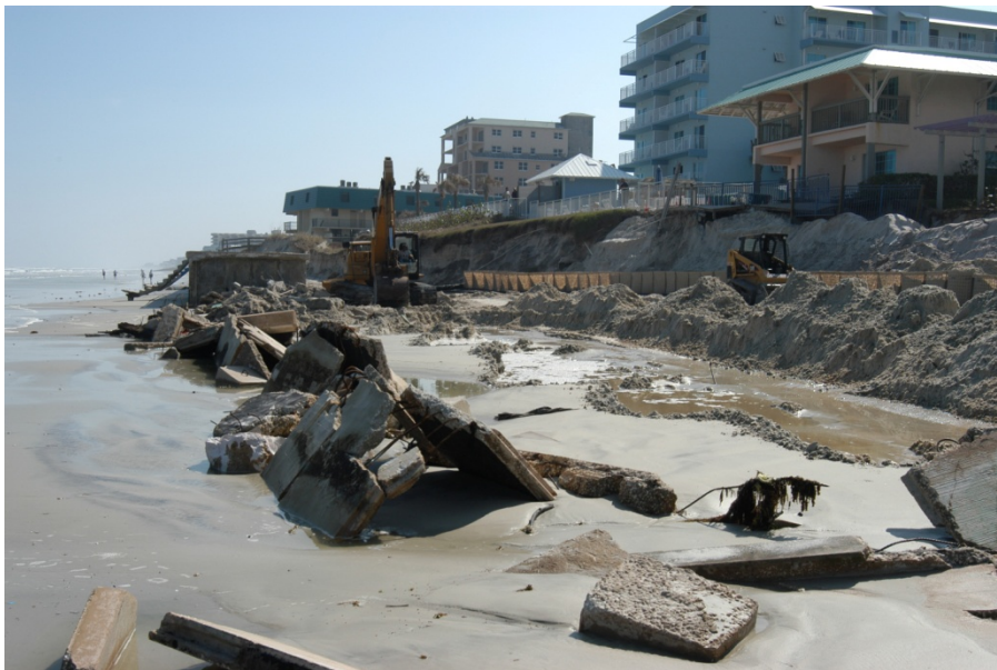
8. kép Viharos hullámzás miatt megsemmisült védógát és part menti erózió Florida keleti részén, 2004. október 27-én (New Smyrna Beach) 66
