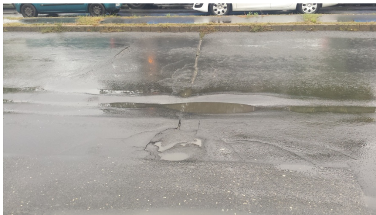
1. kép Nyomvályú, repedés, törés, leendő kátyú az útpályaburkolaton 29
