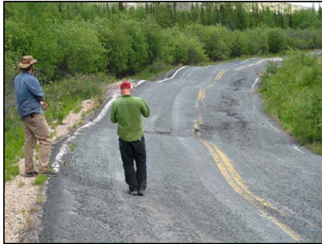
2. kép A Yellowknife-től keletre, Kanada északnyugati részén fekvő 4-es út károsodása, a permafroszt olvadása miatt 37
