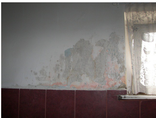
6. ábra: Falazat átnedvesedése a burkolat felett [fotó: tulajdonostól]
